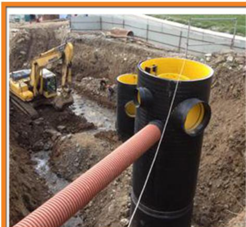
انشعابات پلی اتیلن
